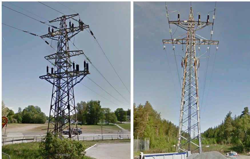
Figur 4. Google Street View Vattenfall Eldistributions ledningar/stolpar och Ellevios anslutande markledning vid Kyrkviken till höger respektive Högberga till vänster.
