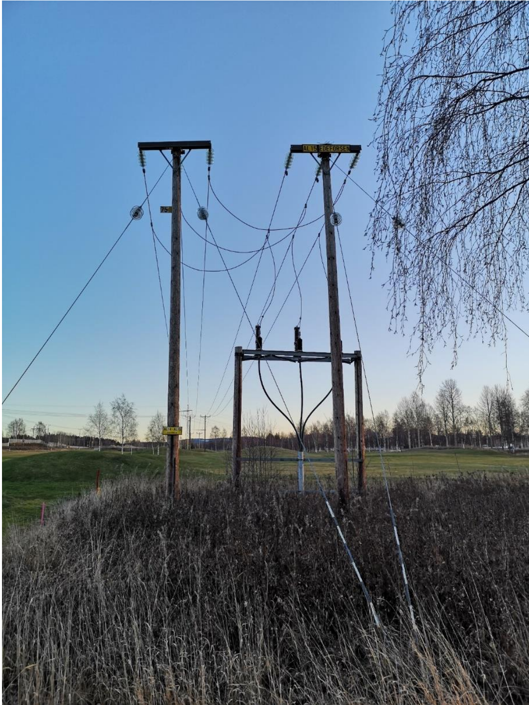
Bild 3. Foto över kabelstolpe där ledning AL15 (till höger i bild) övergår från markkabel till luftledning. Inledningsvis är ledningen sambyggd med ytterligare en 40 kV ledning. I bakgrunden skymtas golfbanan i Ljusdal.
