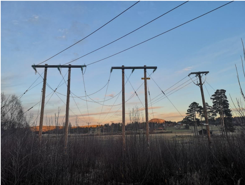
Bild 2. Foto över befintlig ledning AL22 (till vänster) i träportalutförande, närmast transformatorstationen i Stene. I bakgrunden kan ledningen utformad som enbent trästolpe skönjas.
