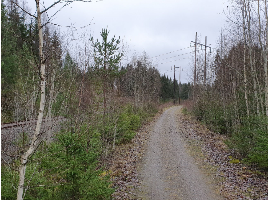
Figur 6. Korsning av väg och järnväg vid L126, Ellevios ledning är den längst fram i bild. Parallellgående tillhör Karlskoga Energi.
