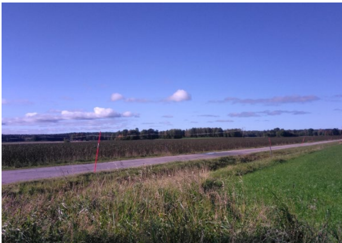
Figur 6. Vägen mellan Borrud och Bengtstorp med Ellevios 145 kV ledning L31 i bakgrunden. Kortet taget mot väster.
