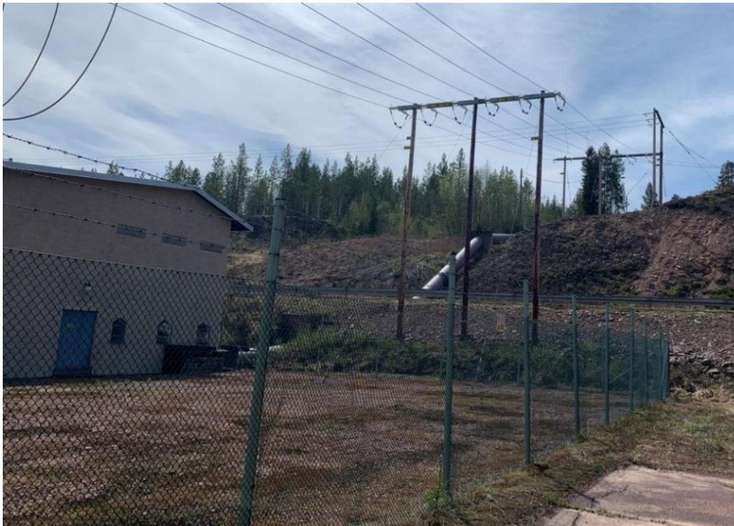
Figur 6. Befintlig luftledning L185 vid anslutningspunkten vid stationen i Ugsiån.
