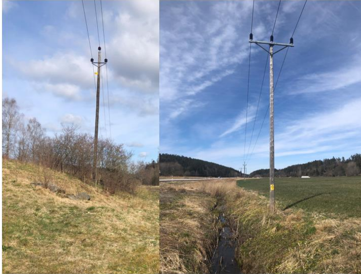
Figur 5. Befintlig ledning TL3 längs sträckan Museröd-Vräland. Exempel på enkelstolpar i trä.
