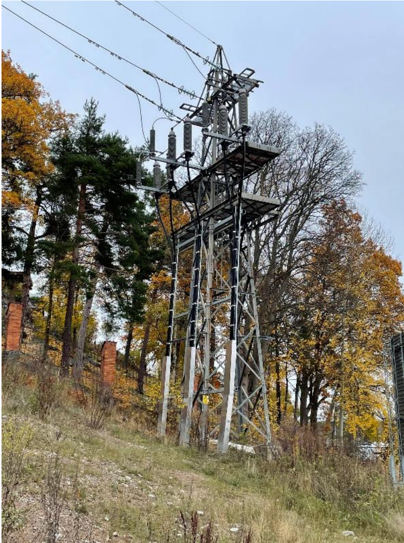
Figur 17. Exempelbild föreställande kabelstolpe som används vid övergång från luftledning till sjökabel.
