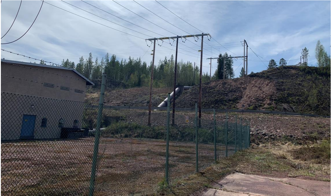
Figur 5. Befintlig luftledning L184 där den går ut från station Ugsiån.
